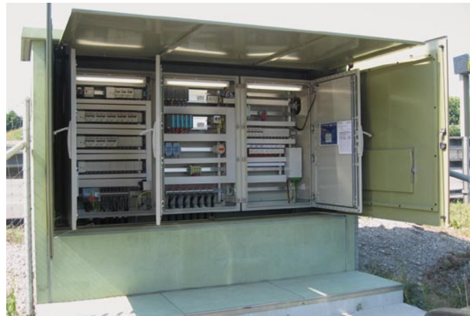
3 Querschnittsteuerkasten für Signalansteuerung.
