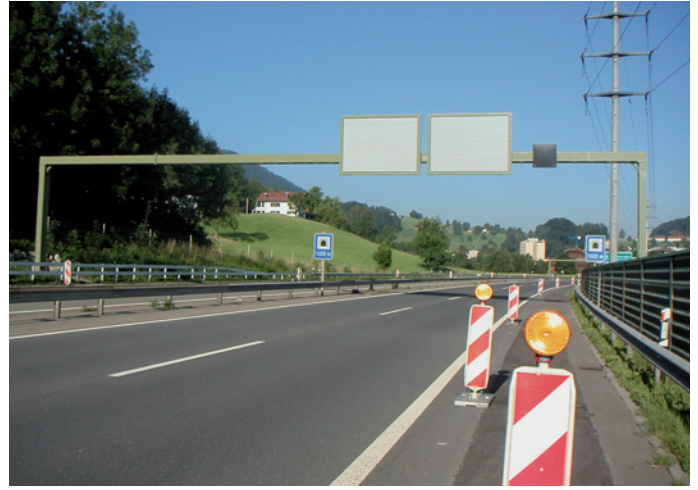
Neue Signalisation mit Wechselverkehrszeichen.
