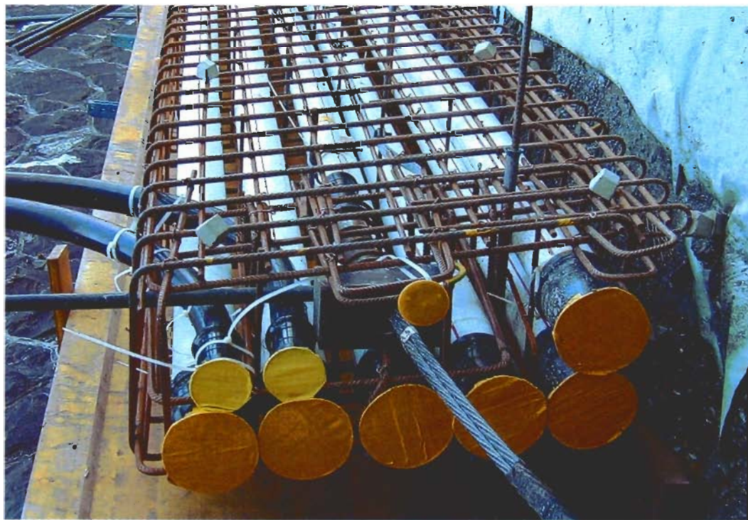
Die Verlegung des Kabeltrassees in einer vorgespannten «New Jersey»-Betonleitmauer in den Abschnitten mit bestehender Beton- oder Natursteinmauer ermöglichte eine Wochenleistung von 120 bis 160 m und entsprach etwa der maximalen Tagesleistung bezüglich der Verarbeitbarkeit des Betons.
